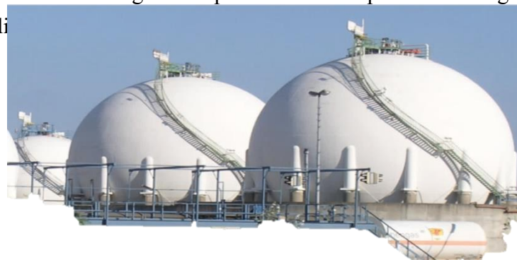
Figure 1.4: Bacs de stockage sphériques ou sphères.
